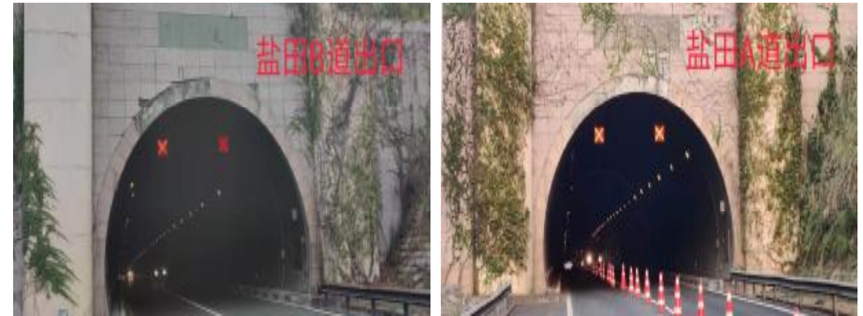
图3-1 盐田隧道洞口花岗岩贴面脱落
